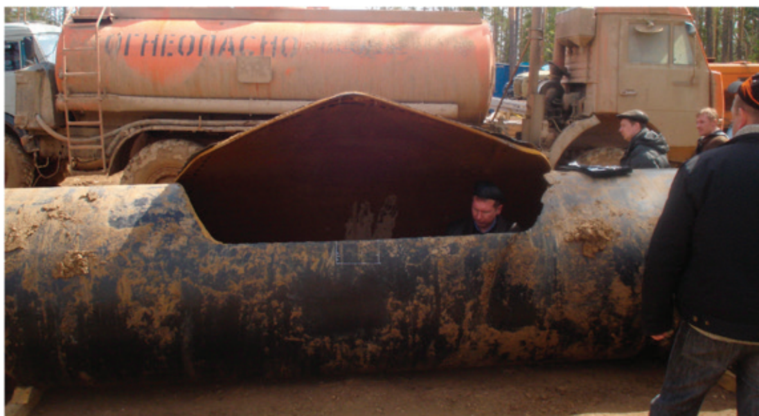
Рис. 4. Вид разрыва трубы после гидроиспытаний на трассе
