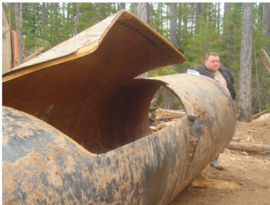
Рис. 5. Вид сбоку разрыва трубы
