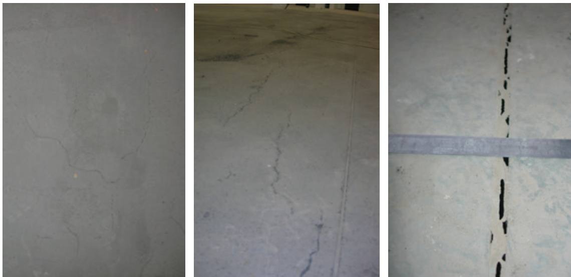
Рис. 1. Характерные дефекты конструкции пола
