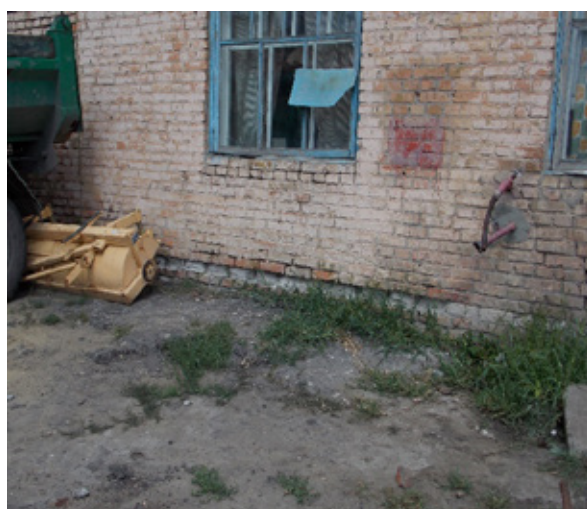
Рис. 3. Наличие сорных трав в районе отмостки (Кат В.)
