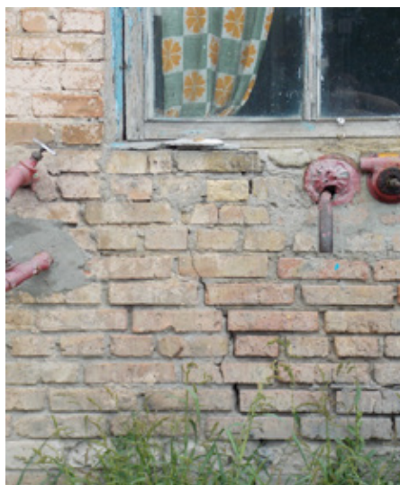
Рис. 1. Трещины в цокольной части (Кат Б.)
