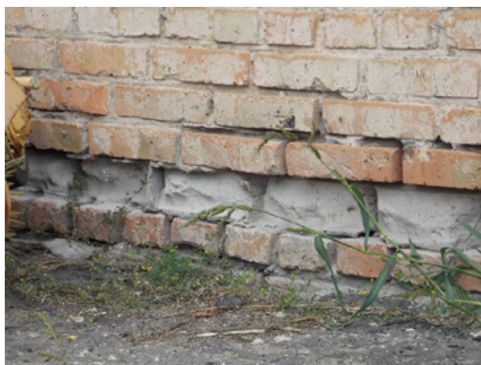
Рис. 2. Размытие кирпичной кладки цоколя (Кат В.)
