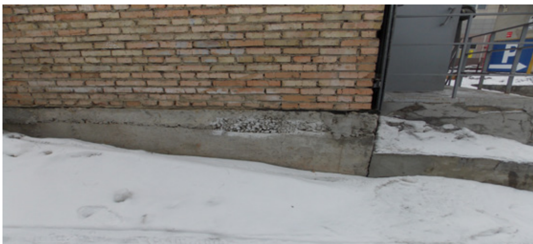
Рис. 1. Трещины в цоколе с раскрытием менее 5 мм
