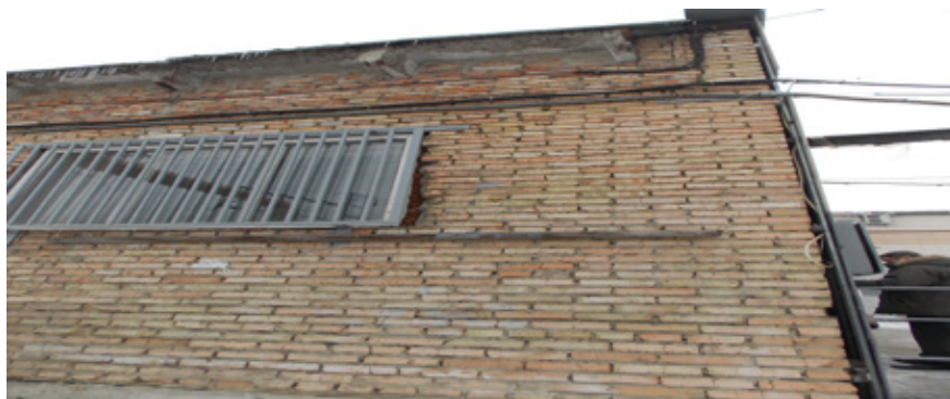
Рис. 3. Скол защитного слоя плит покрытия
