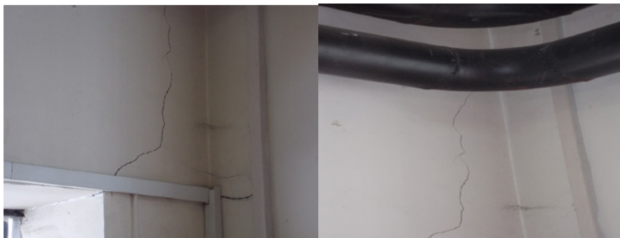
Рис. 2. Отдельные трещины в кирпичной кладке с раскрытием менее 5 мм
