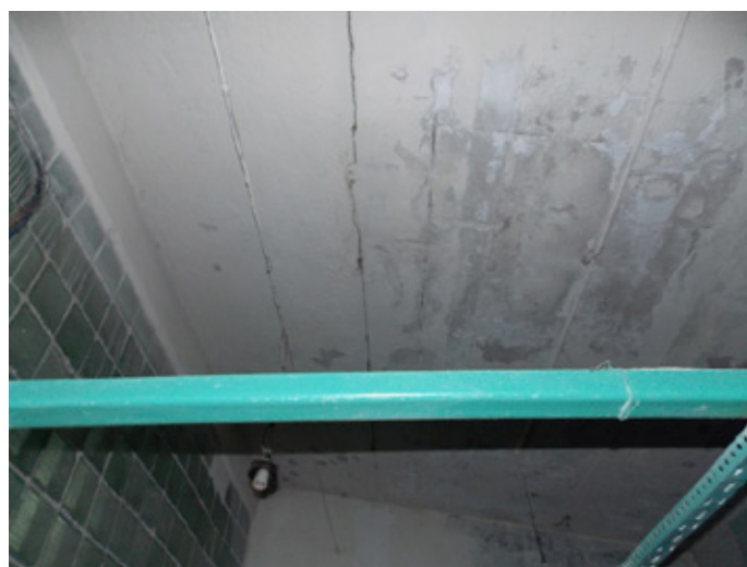
Рис. 7. Замачивание плит покрытия (Кат. В)
