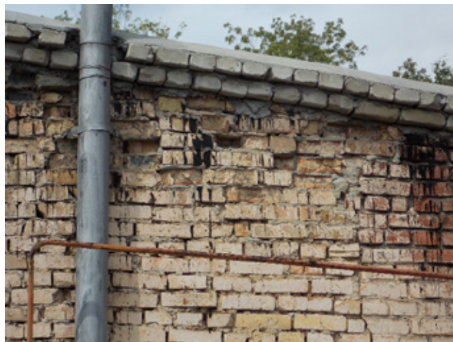
Рис. 6. Выпадение кирпичной кладки (Кат. Б)
