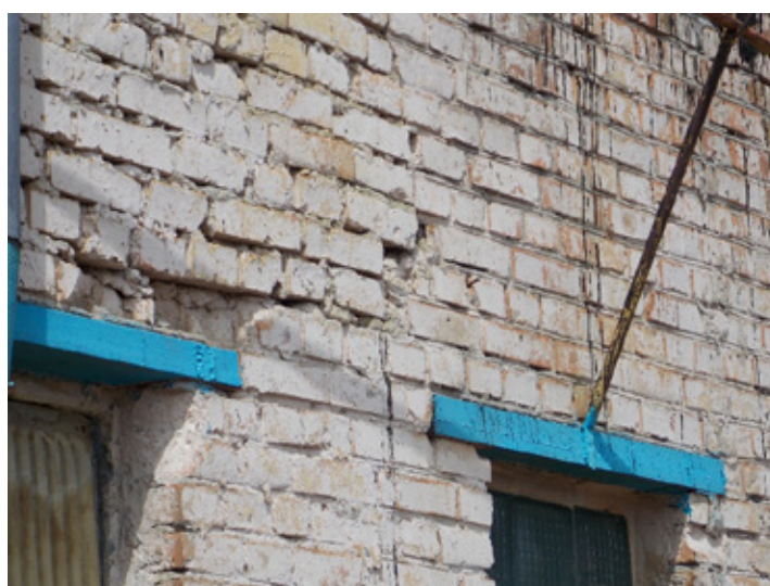
Рис. 8. Выветривание швов кирпичной кладки (Кат В.)
