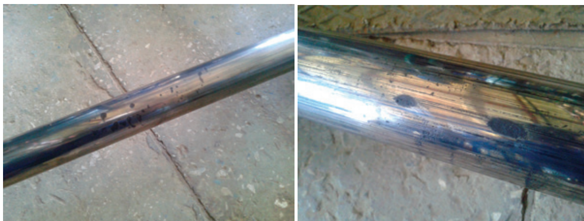
Рис. 4. Точечная коррозия штоков поршневого компрессора
