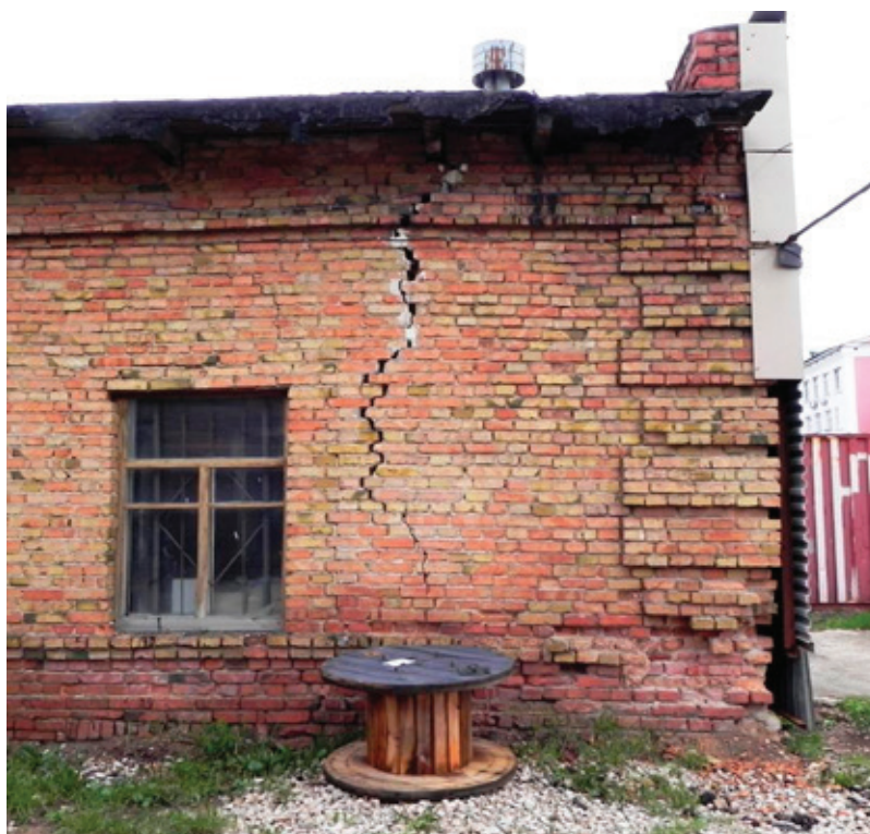
Рис. 3. Вертикальная осадочная трещина
