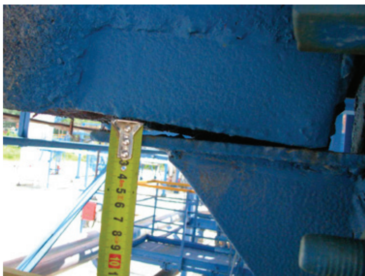
Рис. 5. Зазор между балкой и опорным столиком колонны по оси «Б-8», отм. +4,000
