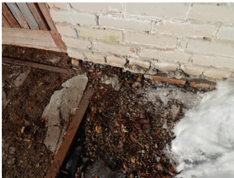
Рис. 4. Разрушение отводки (Категория Б)
