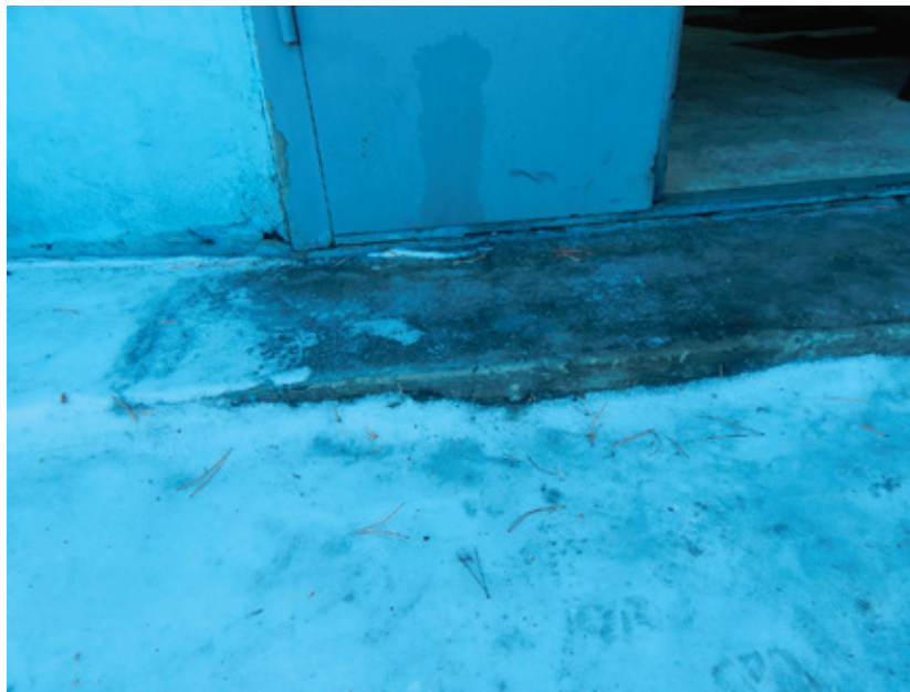
Рис. 2. Трещины в отмостке (Категория В)
