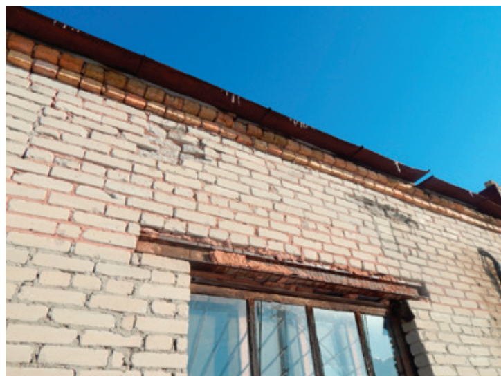
Рис. 3. Мелкие трещины, сколы кирпичей, выветривание швов (Категория В);
