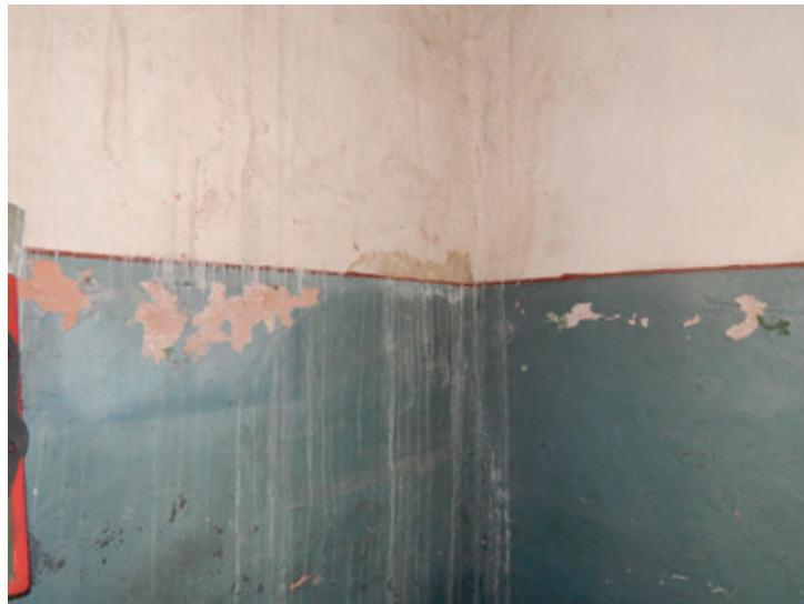
Рис. 2. Следы намочания кирпичной кладки (Категория В);
