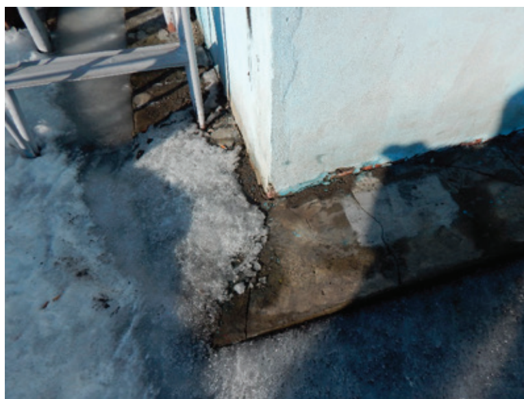
Рис. 2. Трещины в отмостке (Категория В)
