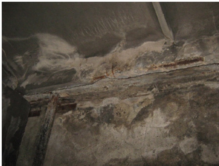
Рис. 1. Коррозия бетона плит покрытия здания с оголением рабочей арматуры, выщелачивание
