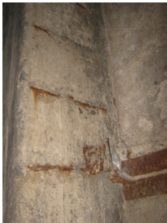
Рис. 2. Коррозия бетона, арматуры и закладных деталей
