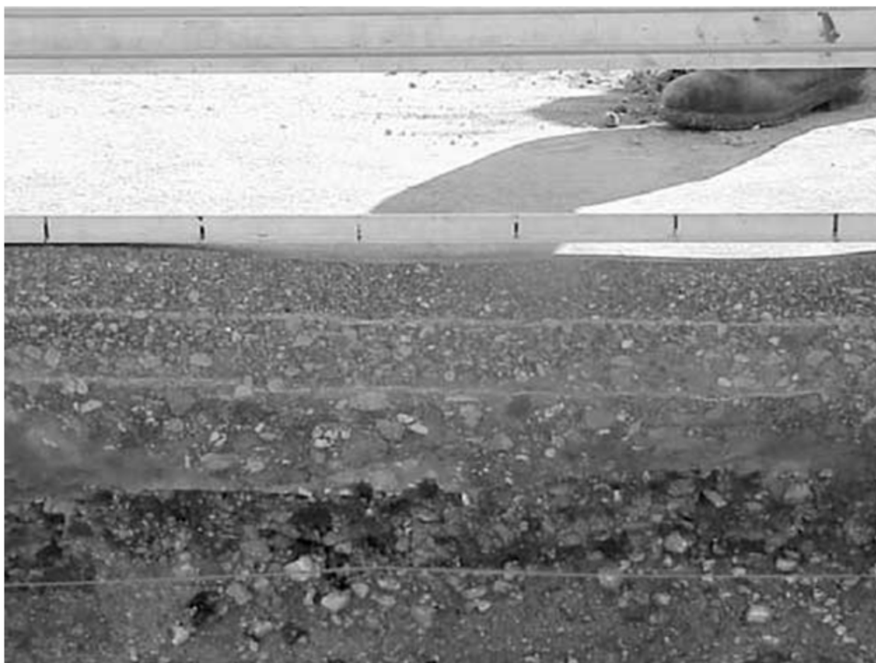
Рис. 2. Глубинная колея, обусловленная пластическим деформированием грунтов земляного полотна и дискретных материалов дорожной одежды
