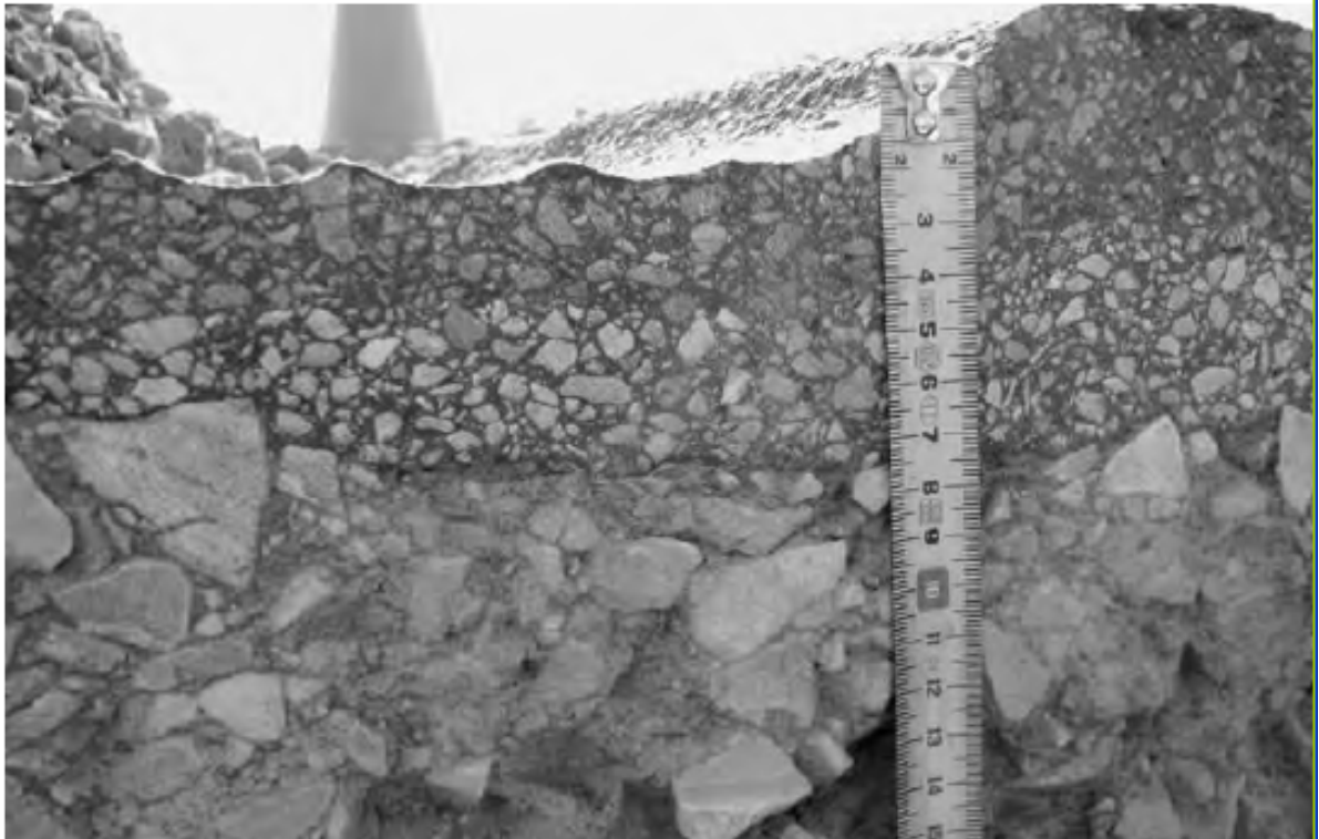
Рис. 3. Поверхностная колея, обусловленная пластическим деформированием Асфальтобетона в слоях покрытия и основания
