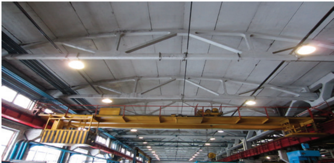
Рис. 5. Общий вид мостового крана
