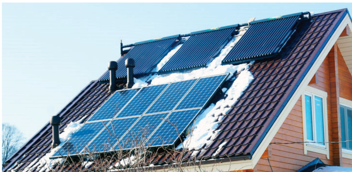
Рис. 2. Пример установки вакуумных солнечных коллекторов (установлены 3 панели у конька крыши) на крыше жилого дома.
