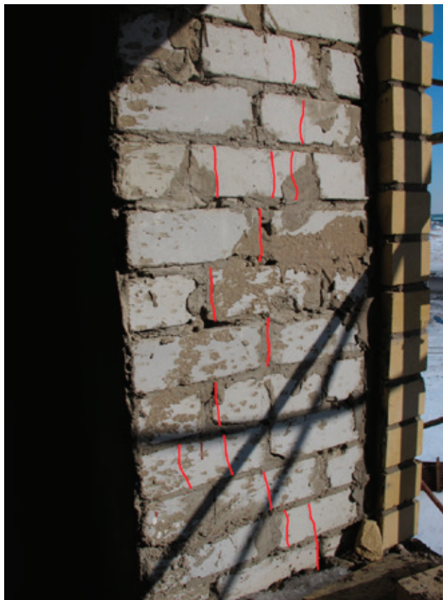
Рис. 2. Трещины шириной раскрытия a_{\text{кр}}=0,01...0,2 мм, пересекающие 11 рядов кирпичной кладки в простенке (подъезд 1)
