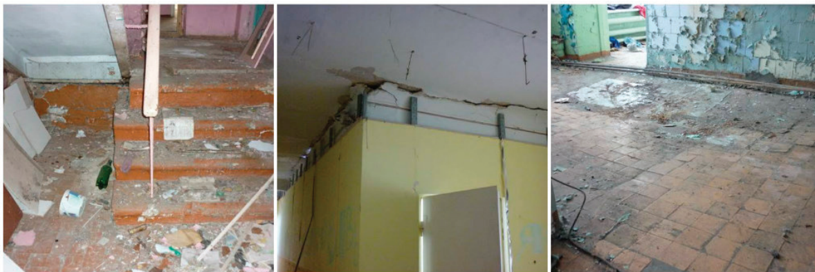
Рис. 2. Техническое состояние строительных конструкций
