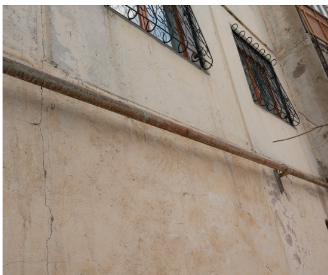
Рис. 3. Повреждение лакокрасочного покрытия по фасаду дома
