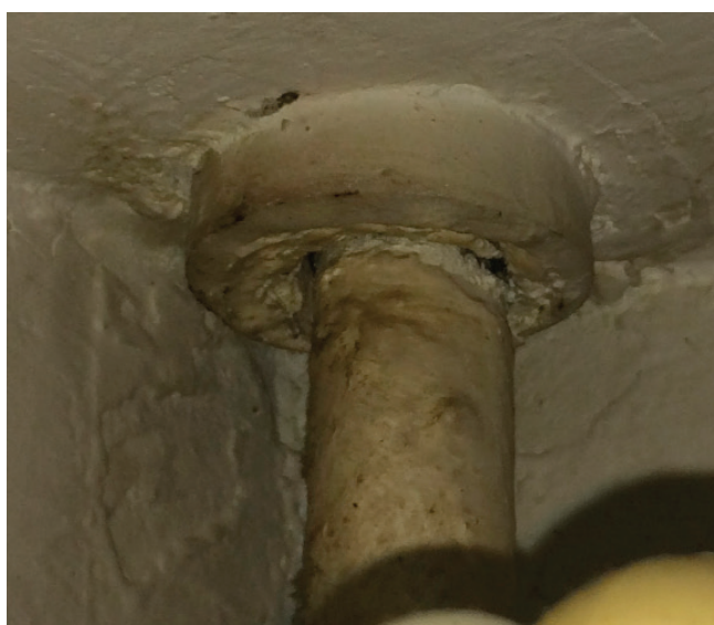
Рис. 4. Разрушение заделки футляра
