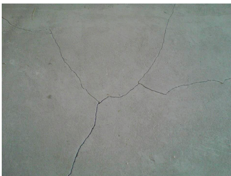
Рис. 2. Трещина на наружной стеновой панели
