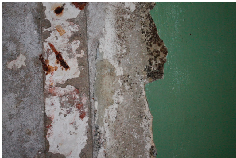
Рис. 2. Пример разрушения материала
