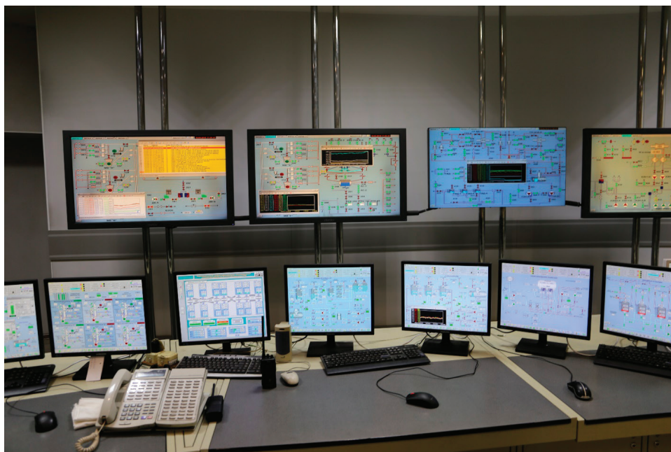
Рис. 2. рабочее место машиниста энергоблока.
