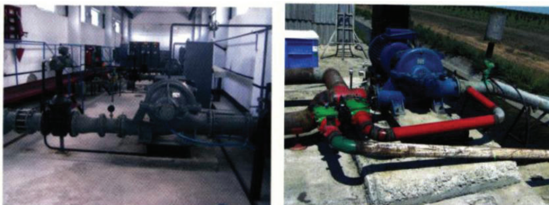
Рис. 2. Виды насосных станций: слева — электрическая стационарного размещения; справа — электрическая станция временного размещения
