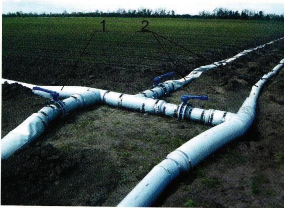
Рис. 3. Общий вид магистральных и распределительных трубопроводов: 1 — магистральный трубопровод; 2 — распределительный трубопровод
