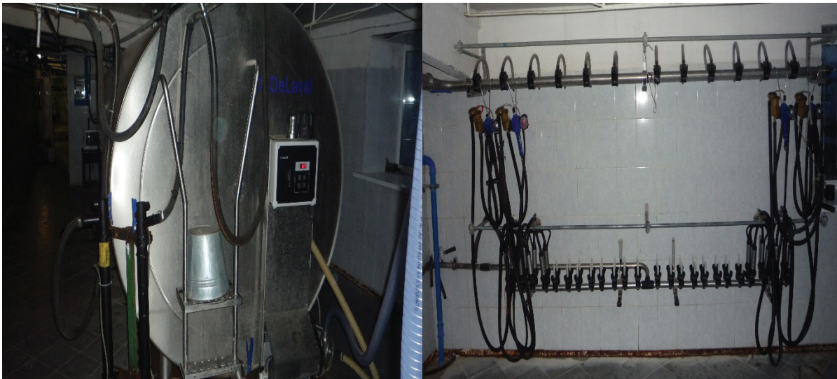
Рис. 2. Доильная установка фирмы DeLaval
