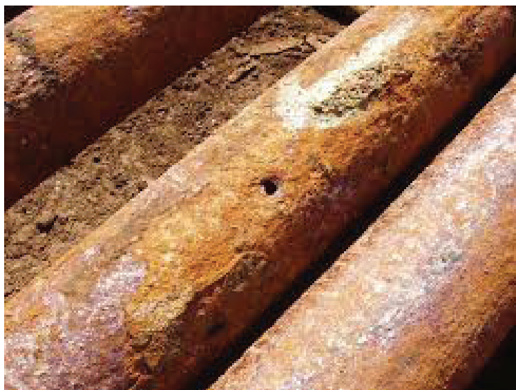
Рис. 2. Сквозные отверстия обсадной колонны в результате коррозии
