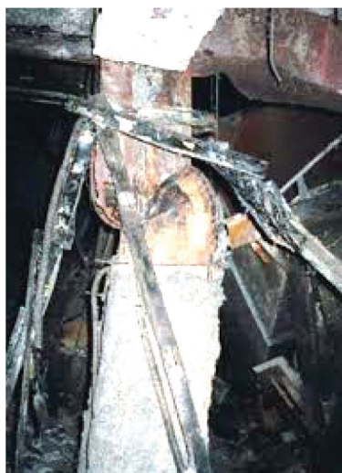
Рис. 2. Аварийное состояние железобетонной колонны
