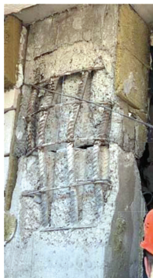
Рис. 1. Поврежденная железобетонная колонна
