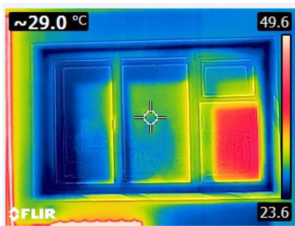
Рис. 1. Термограмма оконного блока, подлежащего замене
