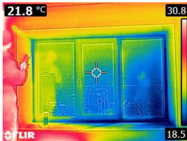
Рис. 2. Термограмма оконного блока из ПВХ-профилей
