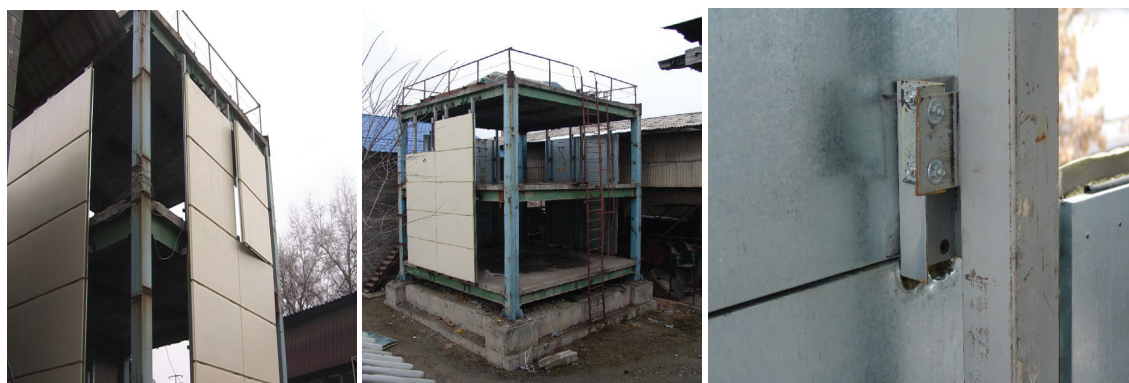
Рис. 6. Состояние панелей после испытаний
