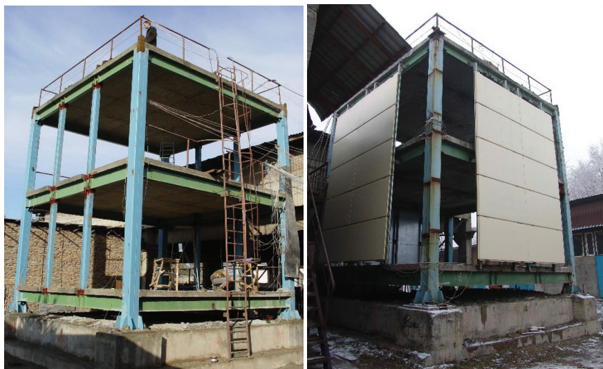
Рис. 3. Экспериментальный стенд с навесными панелями
