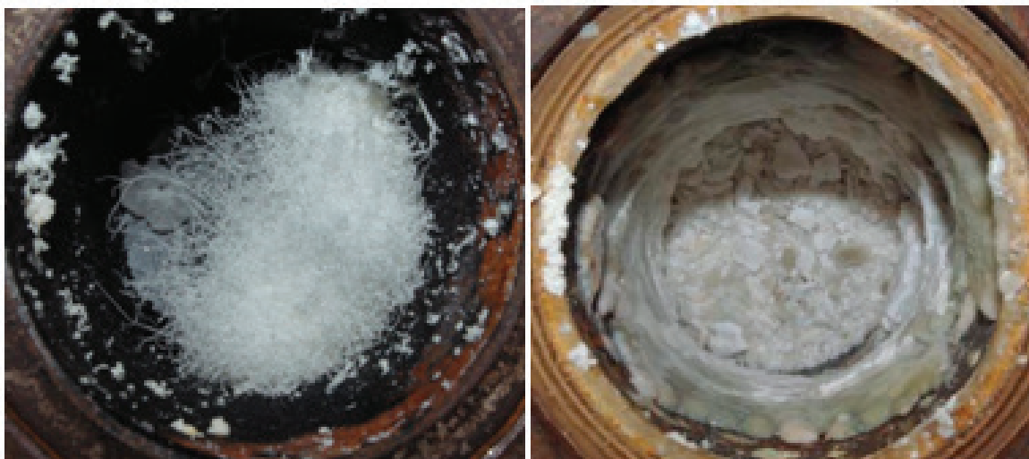
Рис. 1. Отложение гидратов на стенку трубопровода
