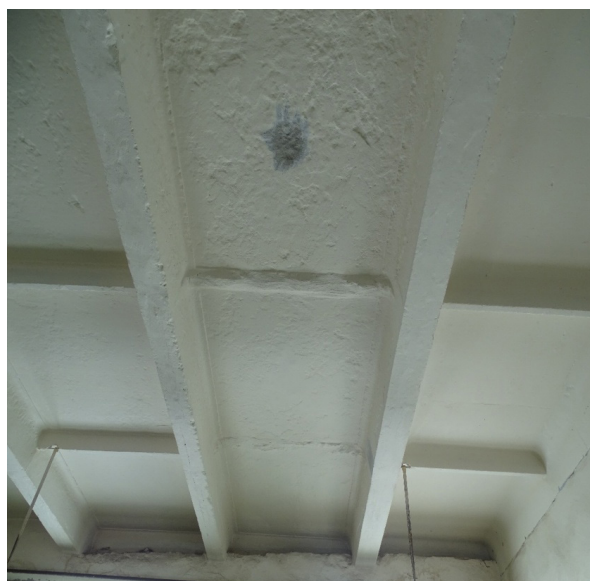
Рис. 1. В плите перекрытия ПКЖ1 отсутствуют два поперечных ребра
