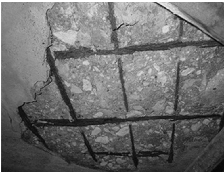
Рис. 1. Коррозия арматуры и осыпание наружного слоя бетона плиты перекрытия
