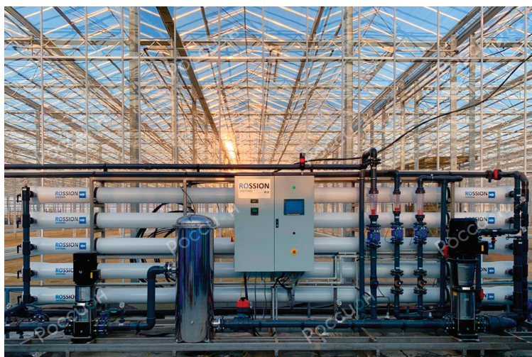
Рис. 2. Станция водо-подготовки для системы туманообразования [4]
