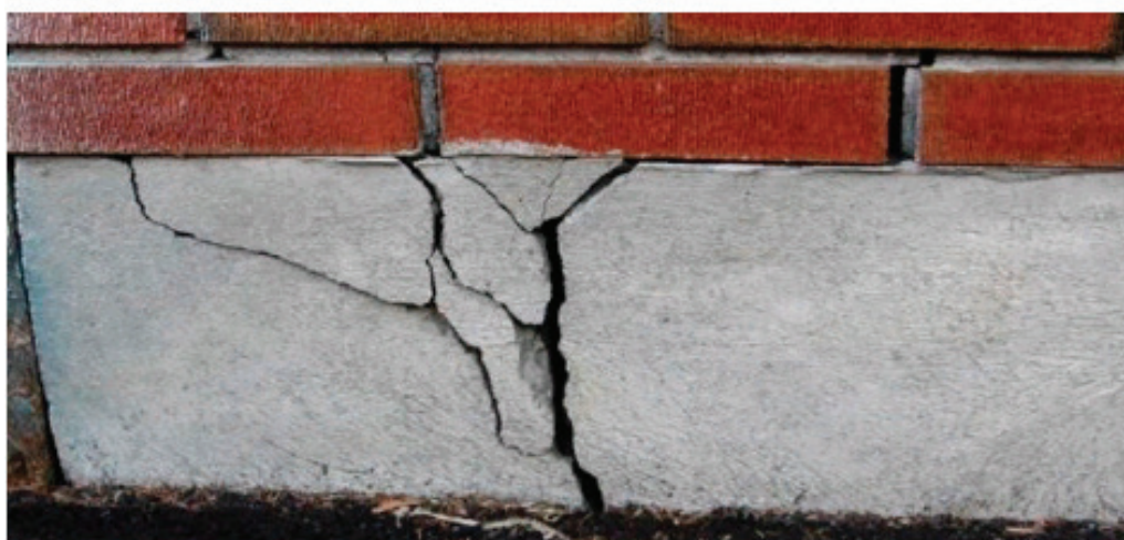
Рис. 1. Деформация и трещина фундамента
