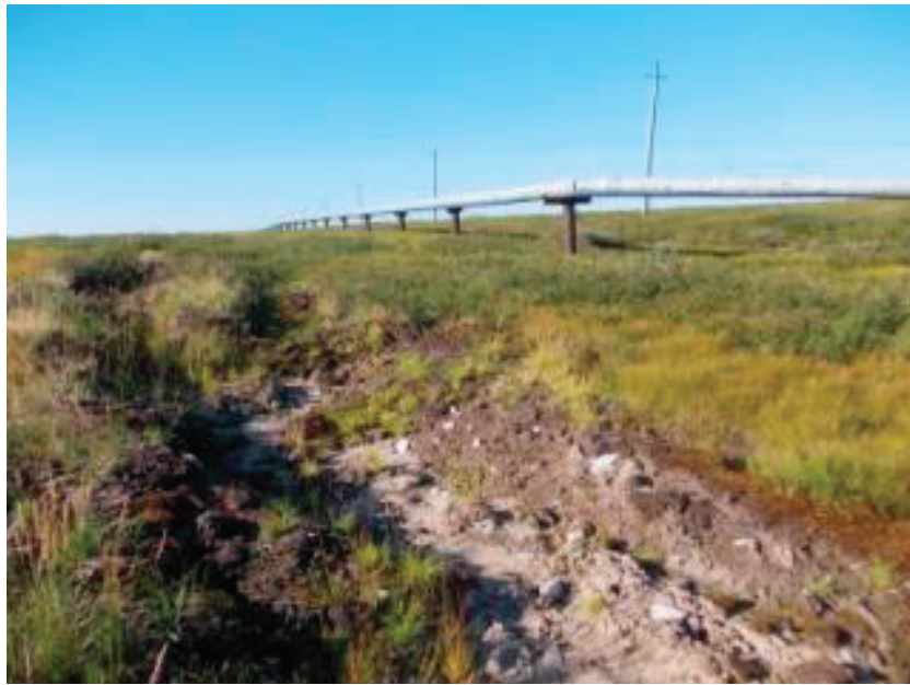
Рис. 3. Эрозионные процессы в районе точки М-6
