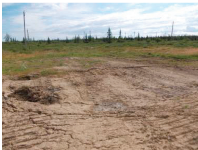
Рис. 1. Просадка грунта за обваловкой. Восточная окраина Веякошорского месторождения
