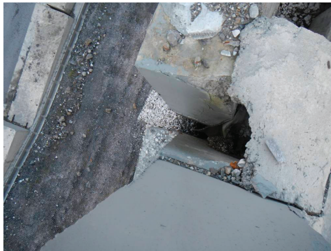
Рис. 6. Наиболее характерные деформации подпорных стен (наличие горизонтального смещения в поперечном направлении секций)
