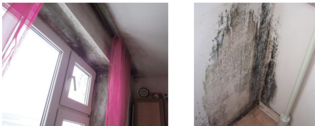
Рис. 5. Плесень на оконных откосах в жилом доме
