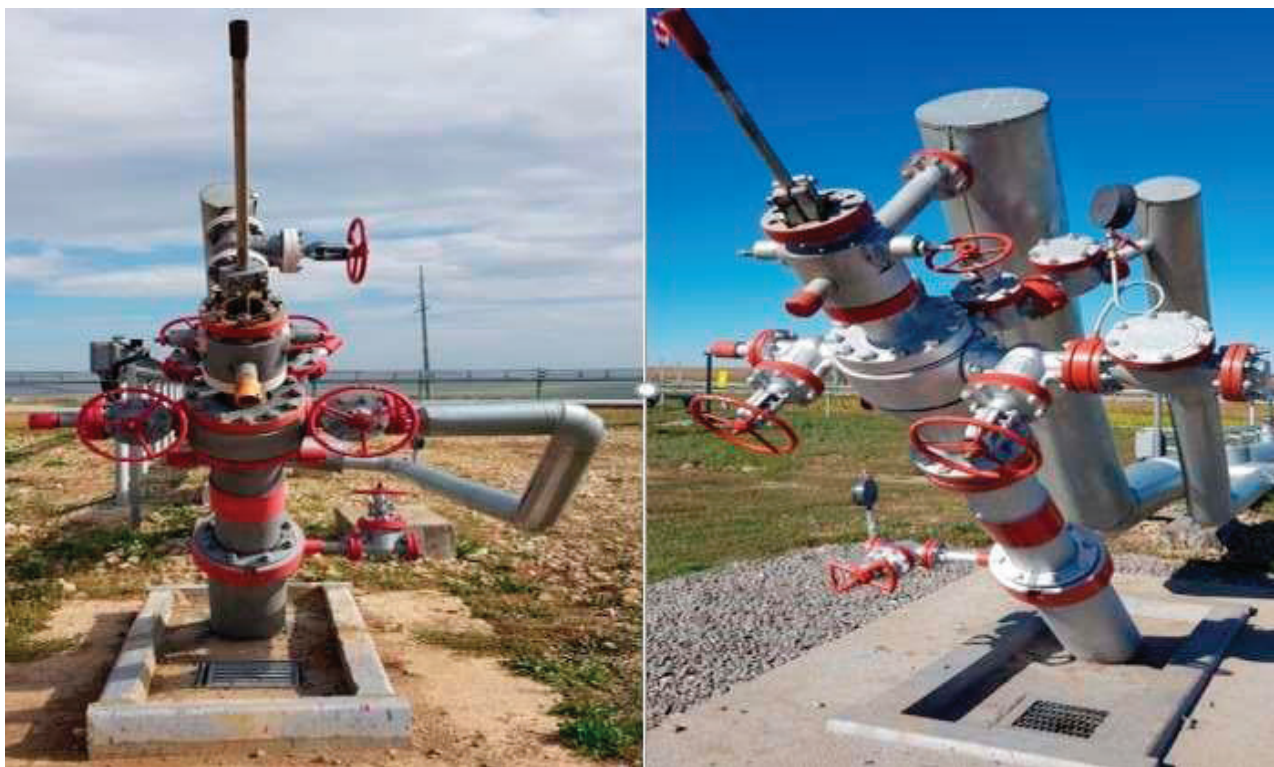
Рис. 2. Устье скважины при паровой закачке (при использовании УШВН)
