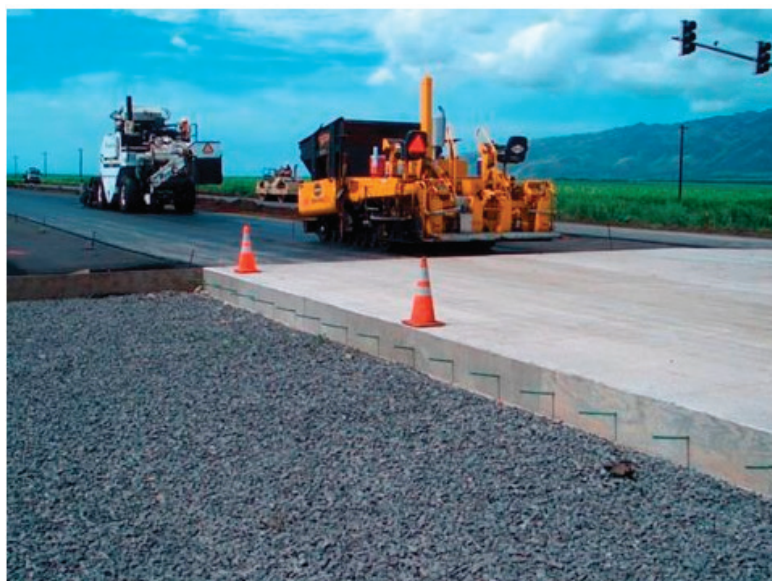
Рис. 2. Дорожная плита из серного бетона
