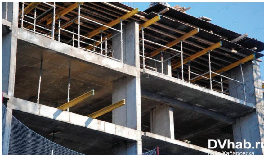
Рис. 3. Использование комбинации бруса и двутавровых балок опалубки перекрытия на объемных стойках на объекте ЖД Поколения г. Хабаровск
