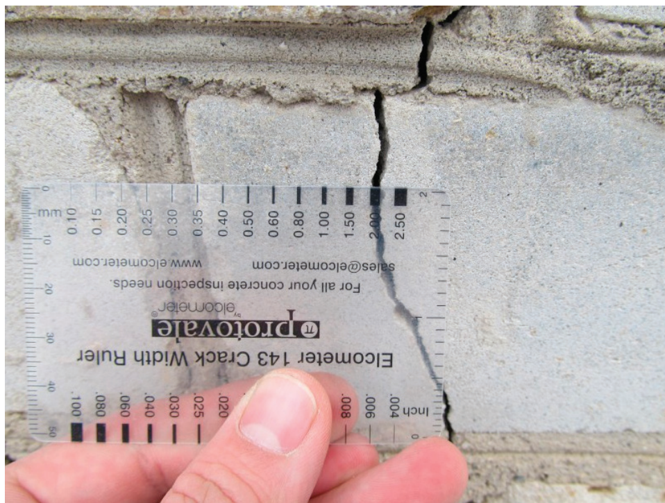
Рис. 3. Измерение размера трещины с помощью специального шаблона
