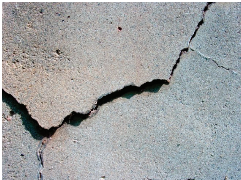
Рис. 1. Трещина в железобетонной конструкции
