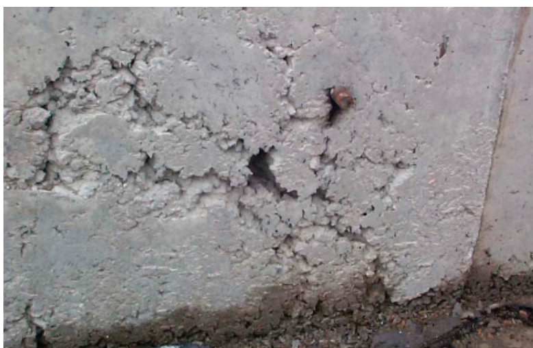
Рис. 2. Разрушение участка стены от вибрационных воздействий
