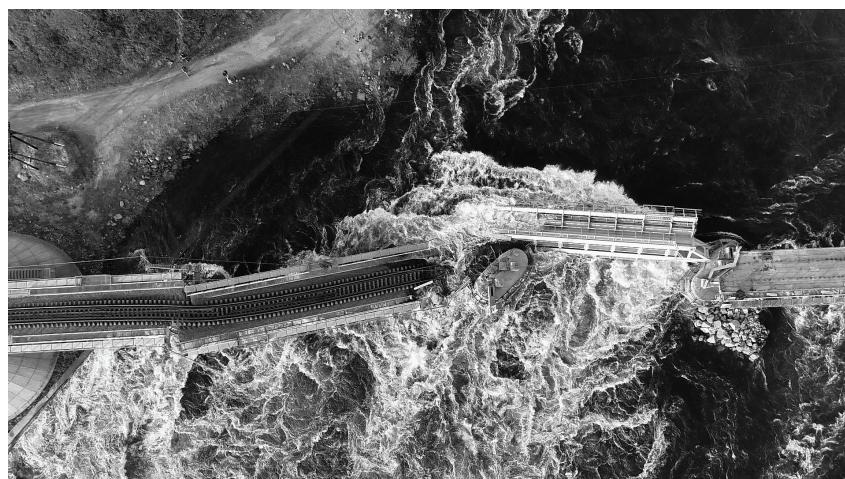
Рис. 3. Обрушение Мурманского моста, 2020 г.
