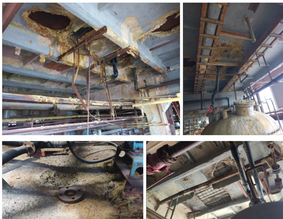
Рис. 1-4. Негативные последствия химически агрессивной среды на железобетонные конструкции промышленного предприятия
