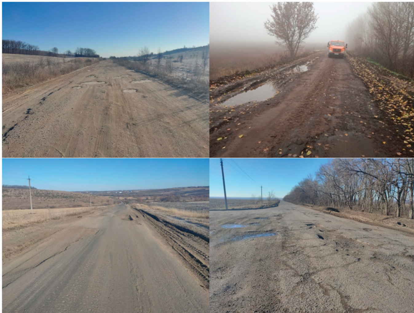
Рис. 3. Фотоматериал а/д с просроченным межремонтным сроком
