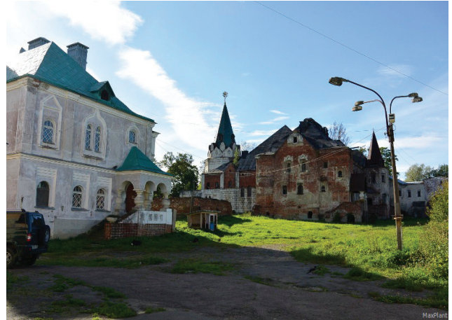
Рис. 2. Состояние наружной кирпичной кладки Розовой и Трапезной палат, Федоровский городок, 2017 г.
