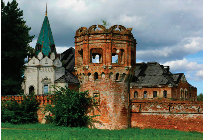
Рис. 1. Состояние наружной кирпичной кладки башни Н, Федоровский городок, 2017 г. (фото из открытых источников)
