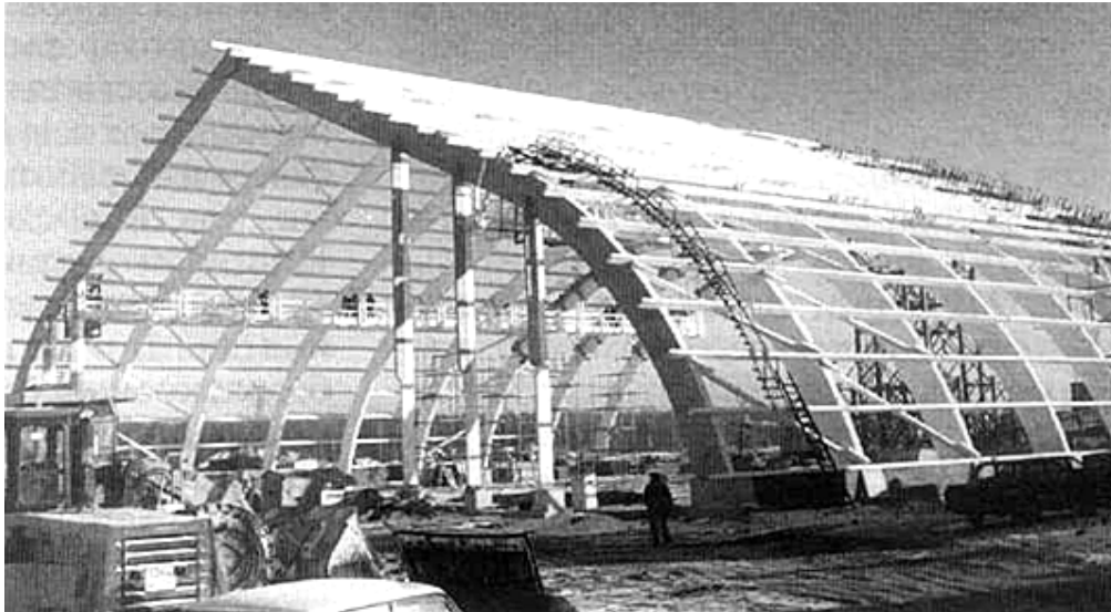
Рис. 2. Арочные конструкции склада противогололедных реагентов в Москве (ул. Суздальская). Пролет 60 м. высота 21 м.
