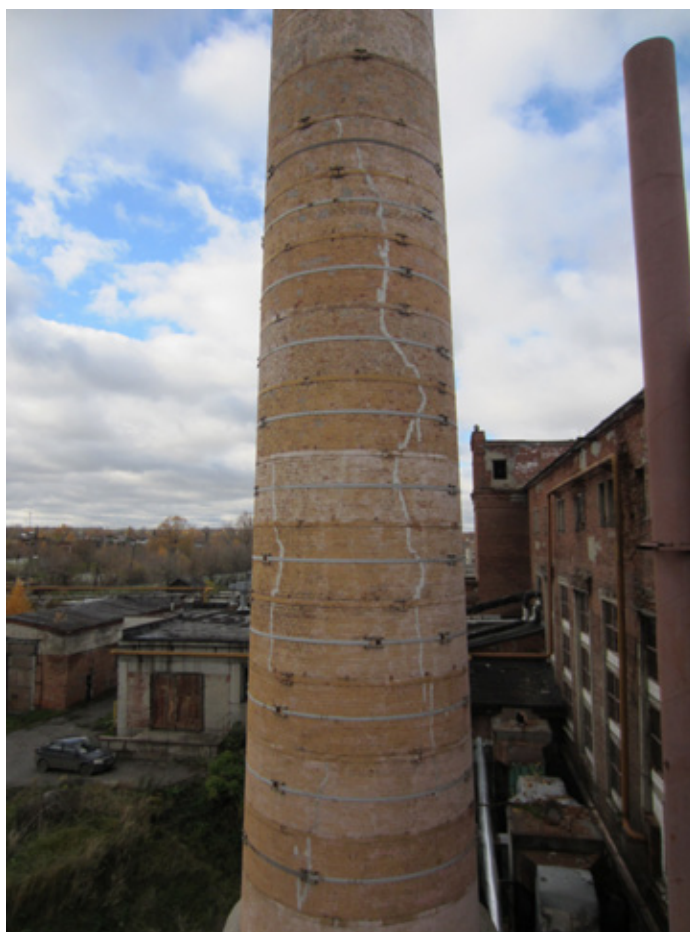
Рис. 5 Трещины после ремонта (г. Пенза)
