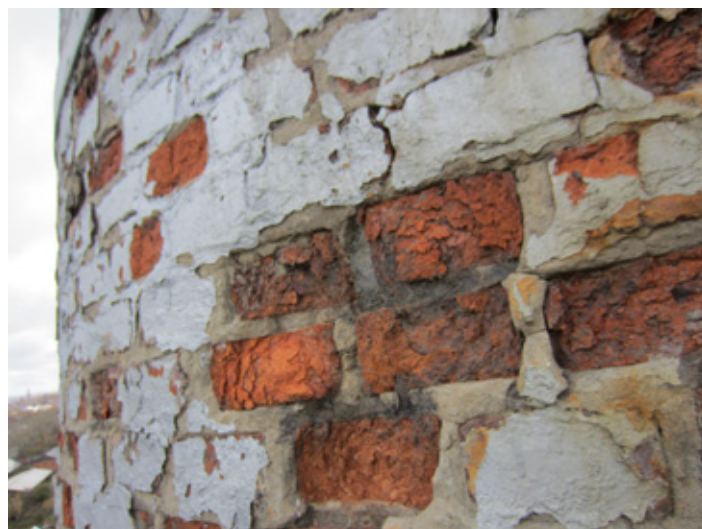
Рис. 3. Выпадение кирпичей на промышленной трубе г. Алатырь, Чувашская республика
