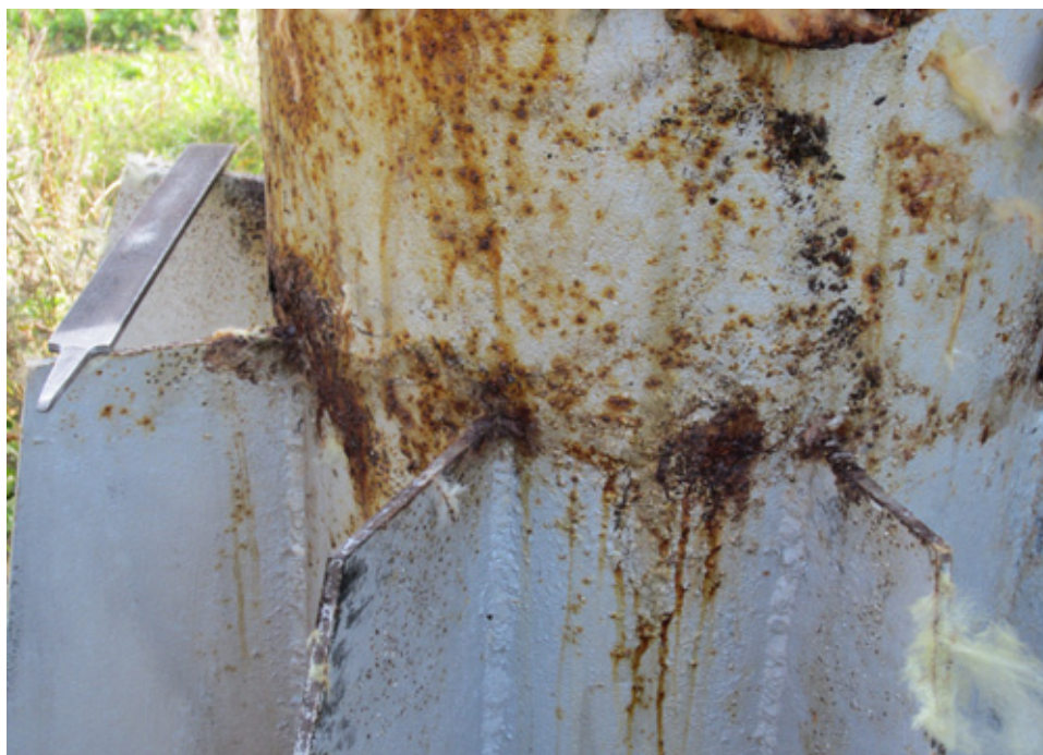
Рис. 2 Коррозия металлической промышленной дымовой трубы в г. Кузнецк Пензенская области
