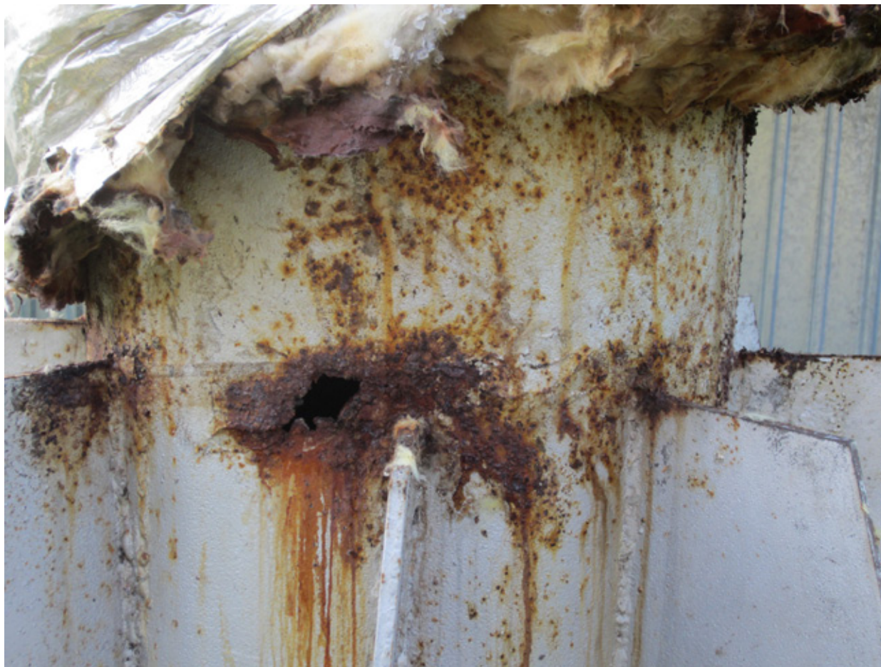
Рис. 1. Коррозия металлической промышленной дымовой трубы в г. Сердобск Пензенской области
