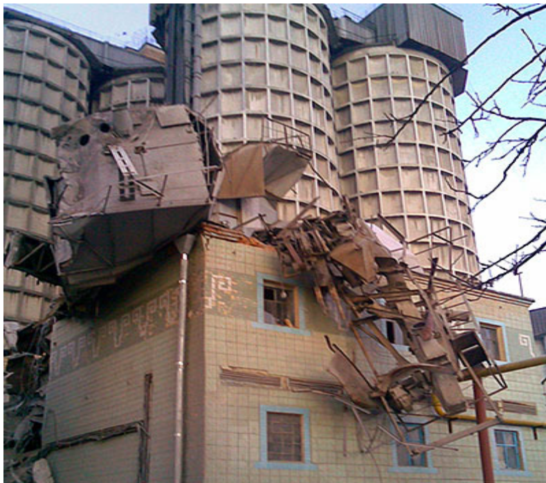
Рис. 3. Обрушения силосной башни высотой 42 м на Бендерском комбинате хлебопродуктов
