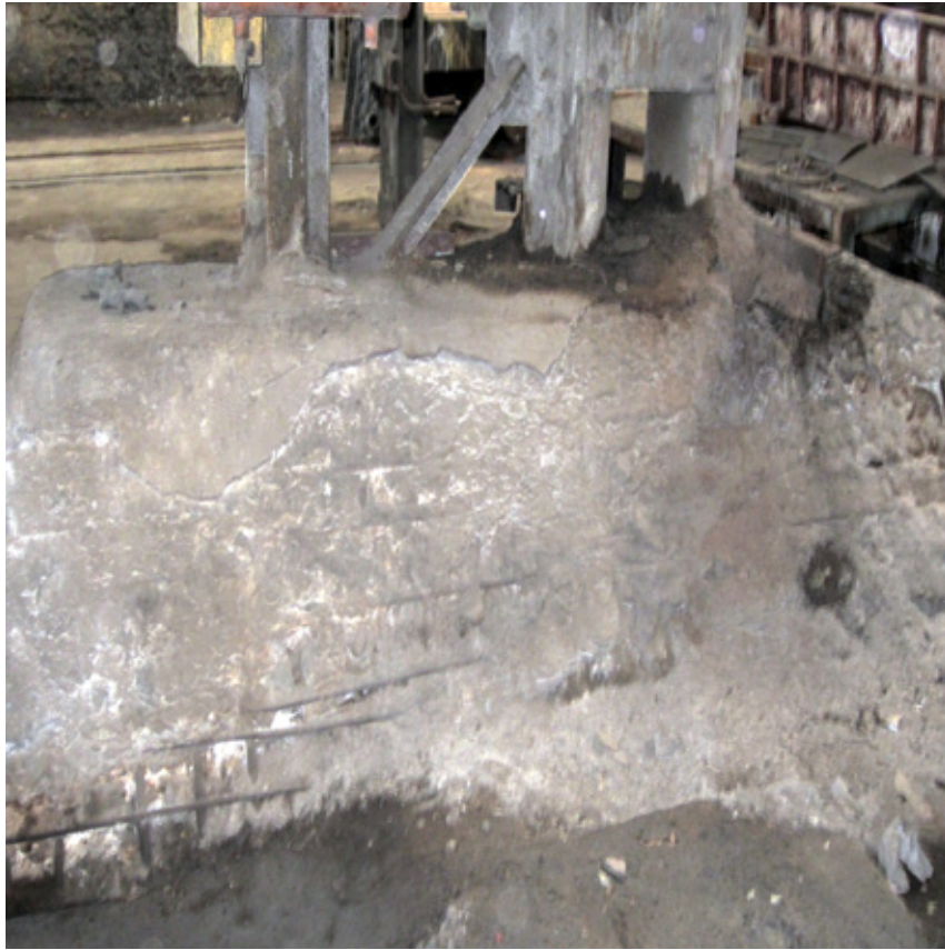
Рис. 2. Частичное разрушение фундамента-основания колонн
