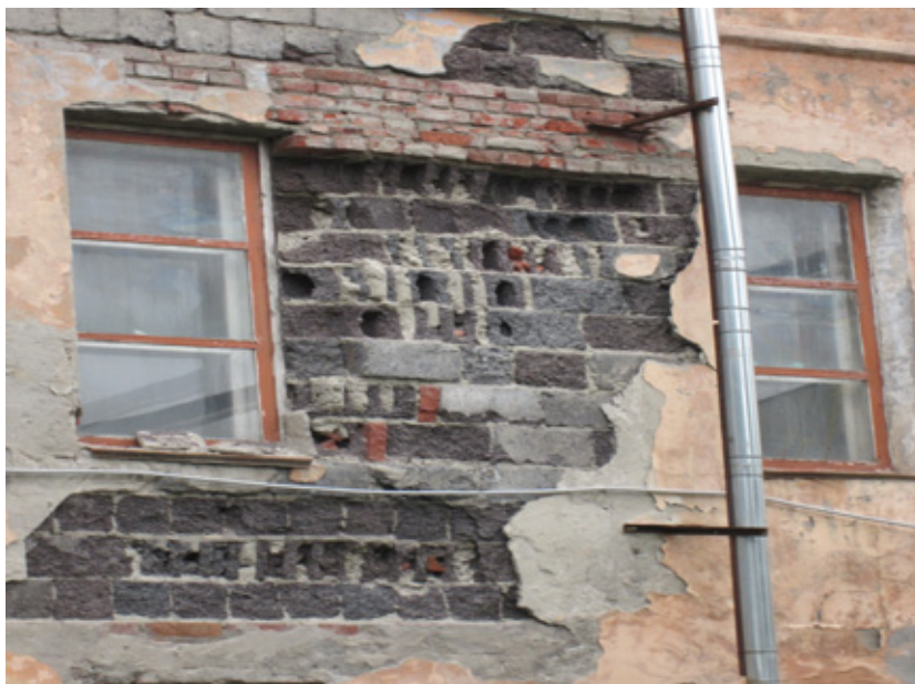
Рис. 3. Частичное разрушение керамзитобетонных блоков наружной стены
