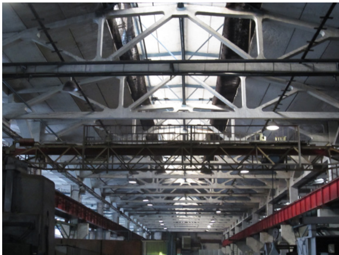
Рис. 2. Следы коррозии стропильных конструкций
