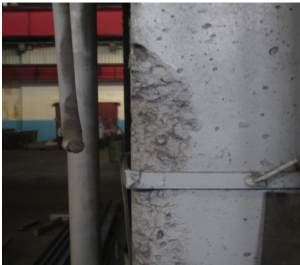
Рис. 1. Скол защитного слоя (без оголения рабочей арматуры)
