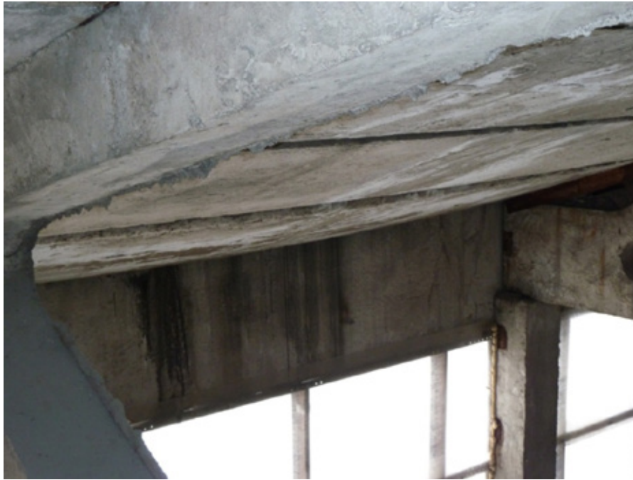
Рис. 1. Прогиб плит покрытия на величину до 60 мм
