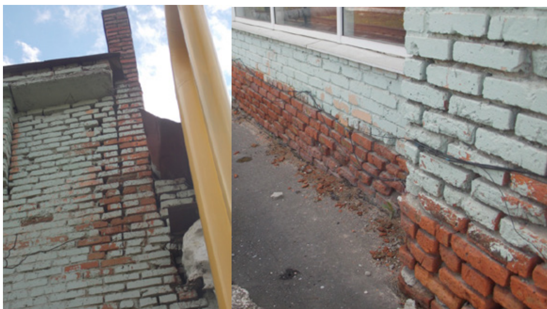
Рис. 3. Выветривание швов кирпичной кладки
