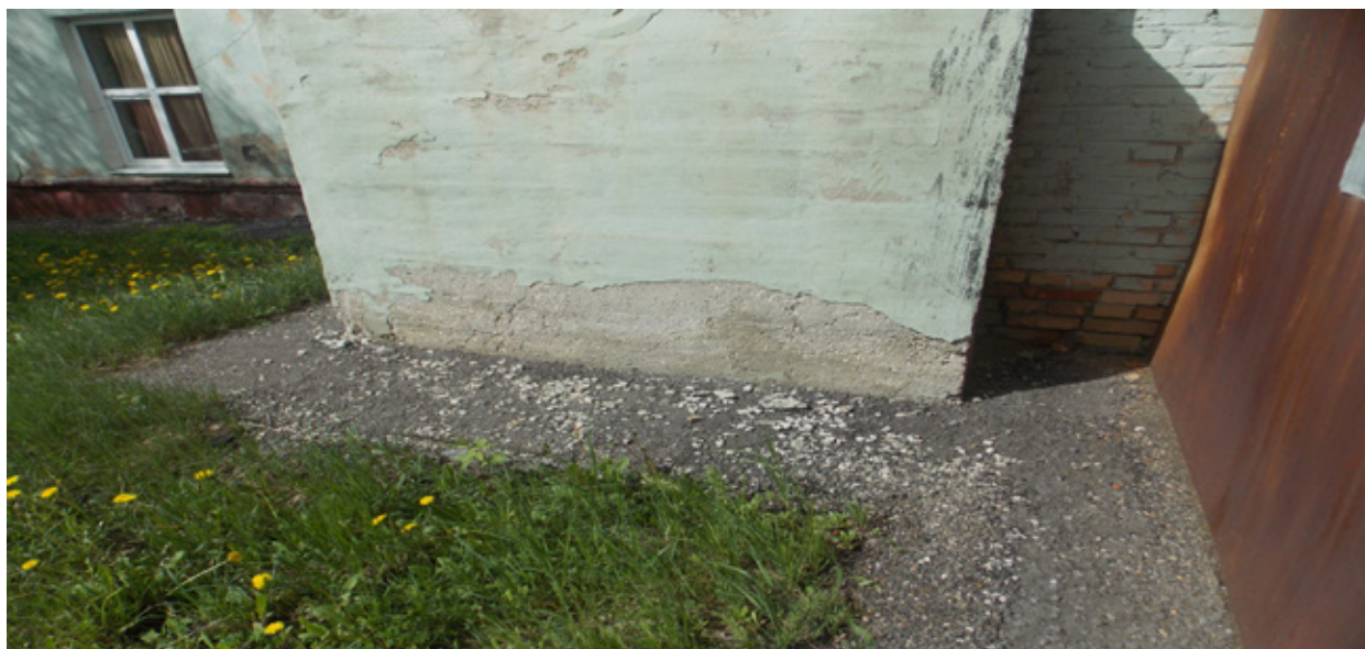
Рис. 2. Разрушение асфальтового покрытия отмостки
