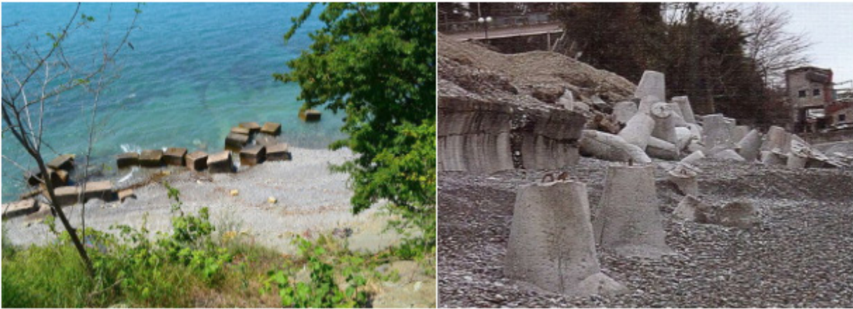
Рис. 2. Пляжи с разрушенными берегозащитными сооружениями, г. Сочи
