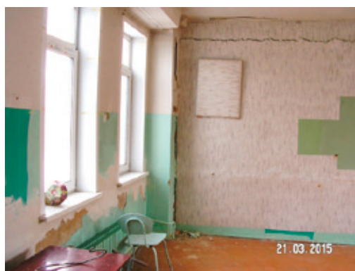
Рис. 2. 3 этаж. Стена в осях Г — Д. Общий вид изнутри. Горизонтальная трещина в сопряжении стеновых панелей
