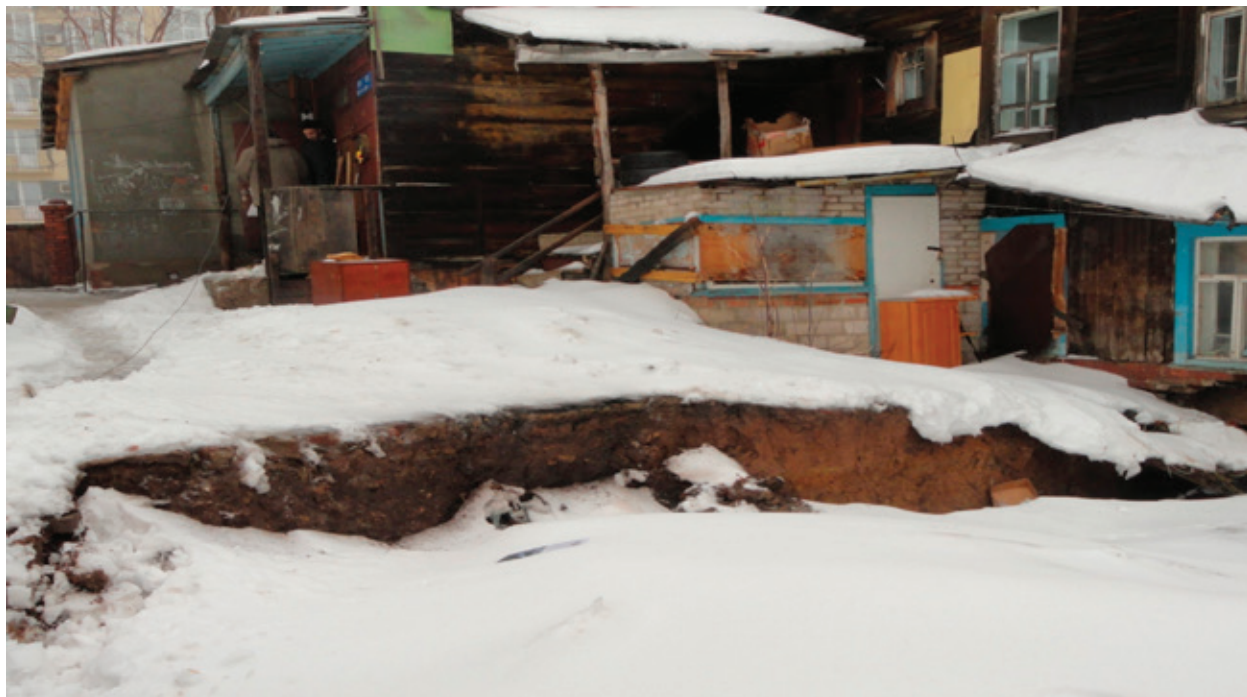
Рис. 2. Надоползневой уступ во дворе дома № 168 по ул. Ленина (фото автора, декабрь, 2012)
