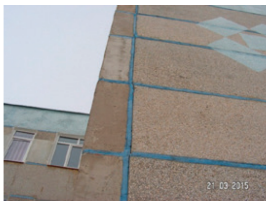
Рис. 3. Общий вид аварийной стены в осях 1-Г. Фрагменты по высоте стены. Трещина в вертикальном шве
