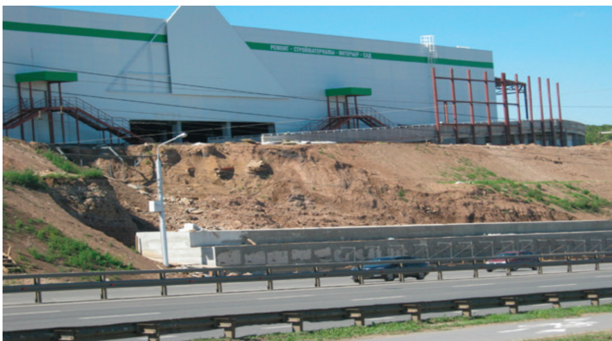
Рис. 3. Оползневой цирк и подпорная стенка на участке сошедшего оползня в микрорайоне Сипайлово (фото автора, июль, 2014)
