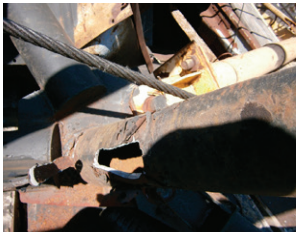
Рис. 4. Разрушения и недопустимые деформации портала
