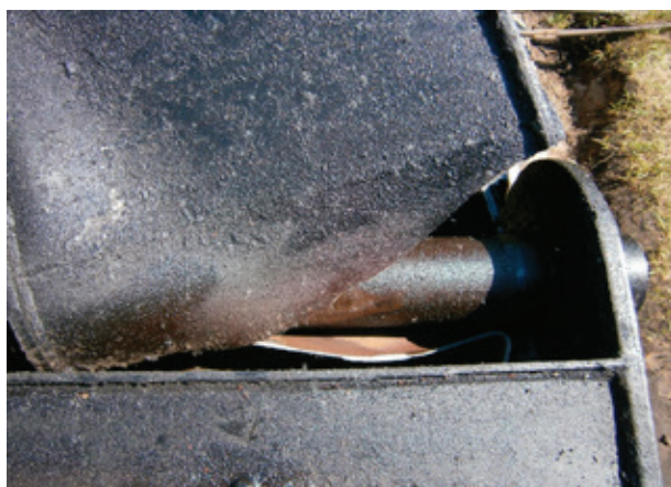
Рис. 3. Разрушение нижнего опорного фланца флюгера ходовой рамы
