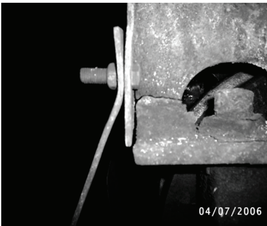
Рис. 4. Трещина концевой балки с нетроллейной стороны у ведомого катка
