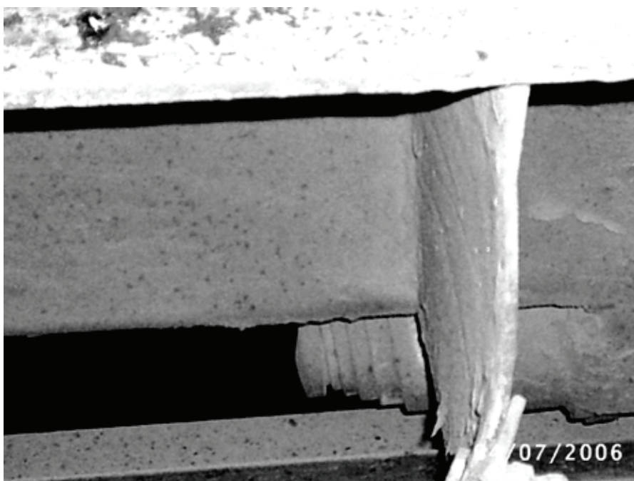
Рис. 2. Деформация ребер жесткости металлоконструкции грузовой тележки со стороны проходной галереи
