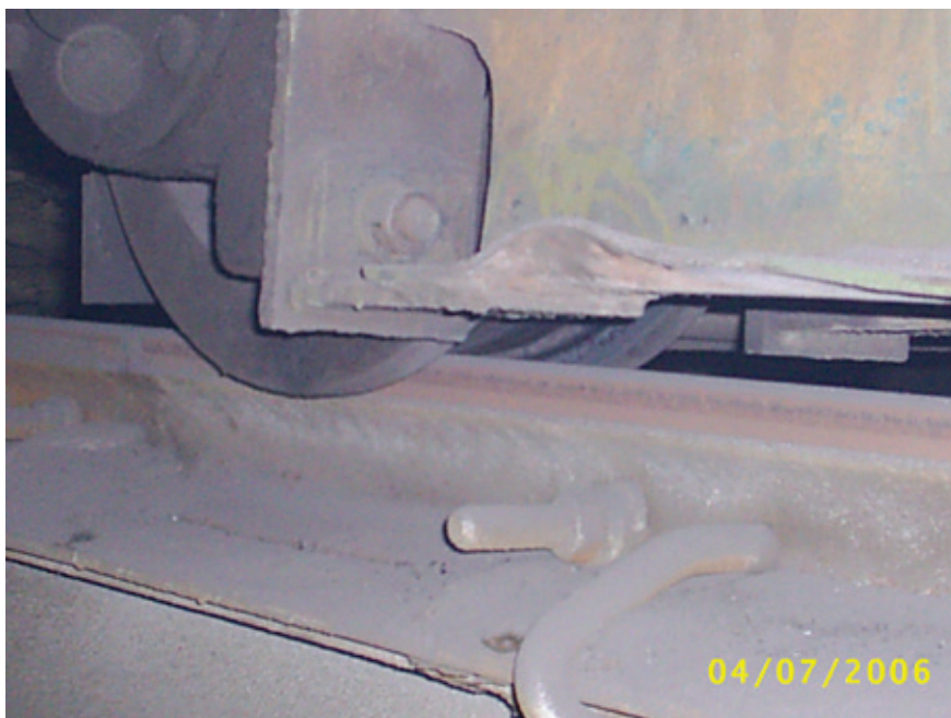
Рис. 3. Деформация несущих конструкций
