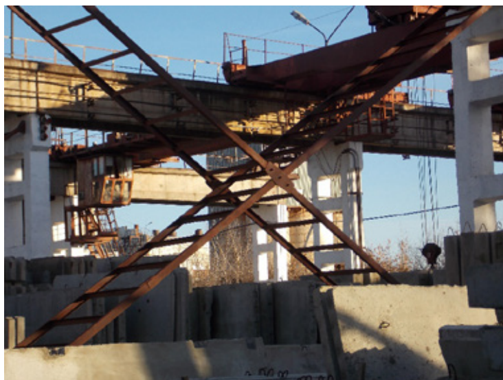
Рис. 3. Нарушение лакокрасочного покрытие связей, следы коррозии металла (Категория В)
