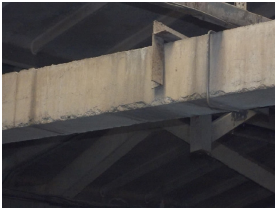
Рис. 4. Мелкие сколы и выбоины на железобетонных фермах (Категория В)
