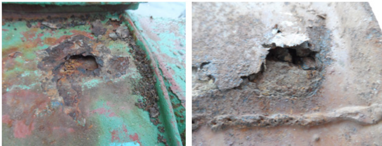
Рис. 6. Сквозная коррозия корпуса
