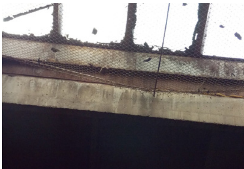
Рис. 8. Нарушено крепление защитной сетки светоаэрационного фонаря с металлической балкой (Категория В)
