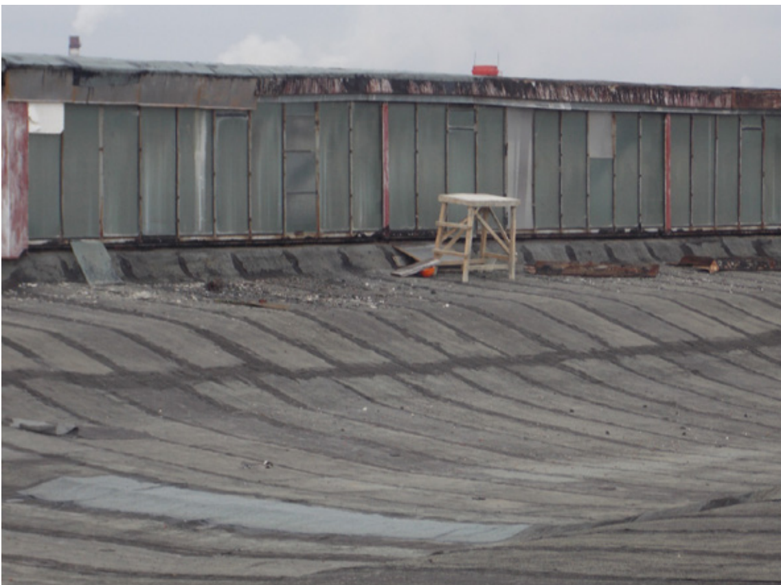
Рис. 2. Посторонние предметы на кровле (Категория В)
