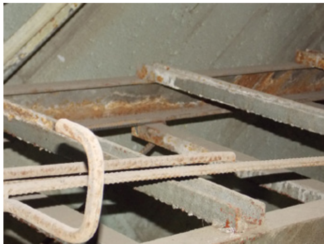
Рис. 5. Нарушение лакокрасочного покрытие связей, следы коррозии металла (Категория В)
