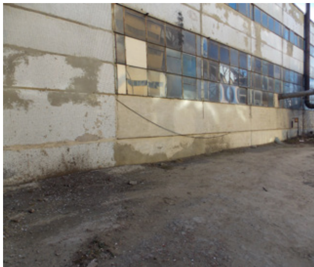
Рис. 6. Разрушение декоративного слоя ограждающих панелей (Категория В)
