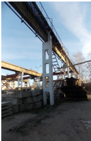
Рис. 2. Мелкие сколы и выбоины на железобетонных колоннах (Категория В)
