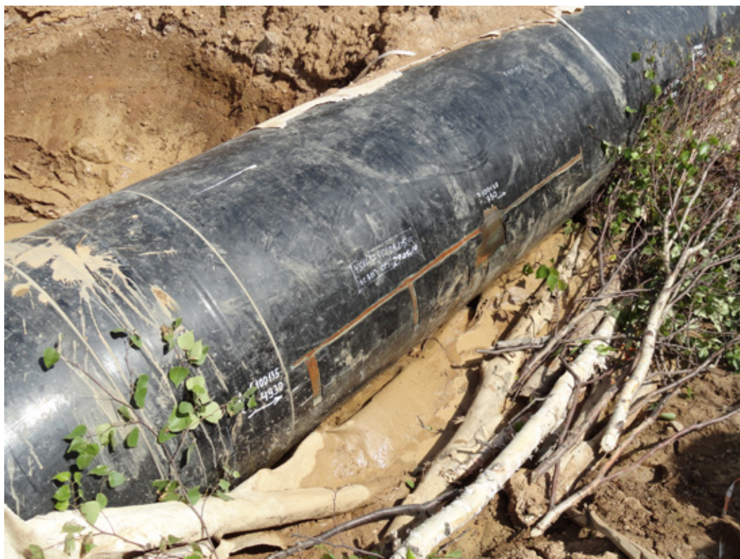
Рис. 2. Дефект риска на поверхности стальной трубы
