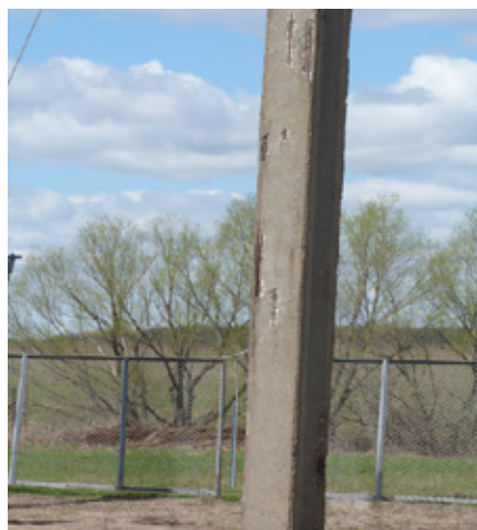
Рис. 3. Отслоение бетона, оголенная арматура стойки разъединителя 110 кВ
