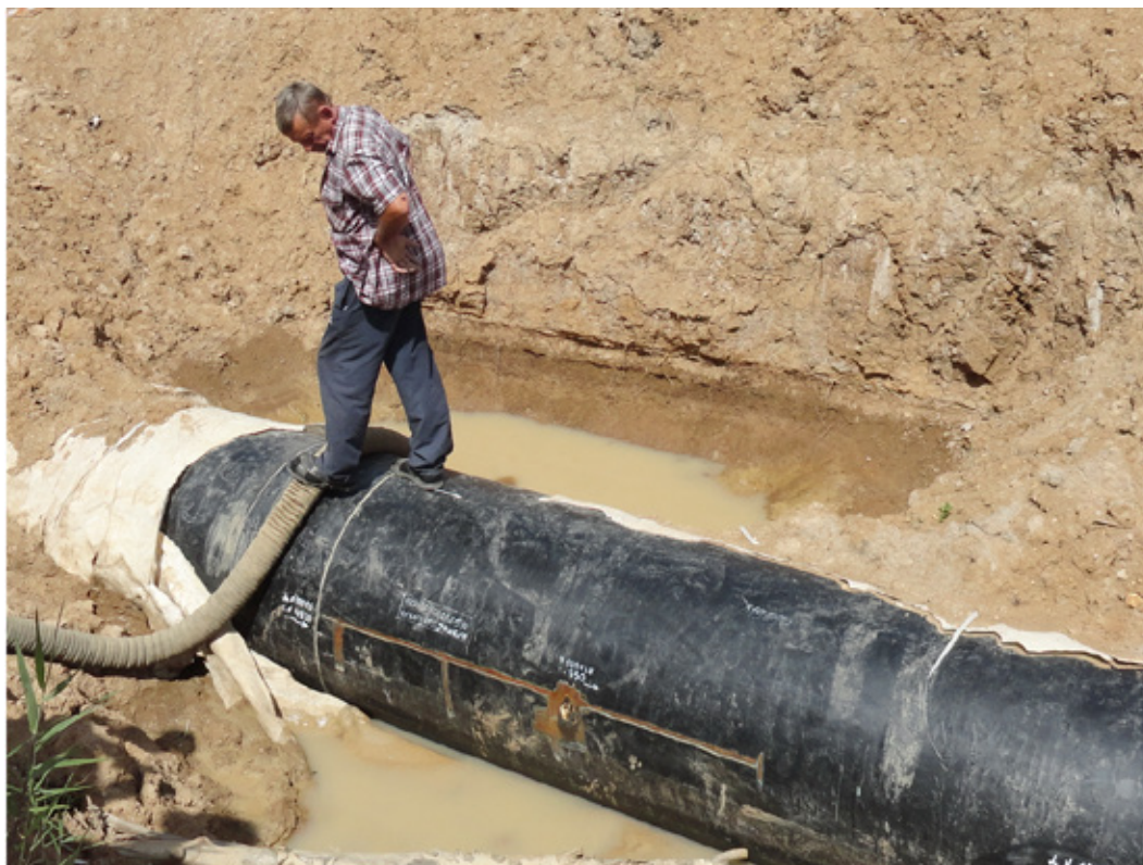
Рис. 1. Экспертиза автором статьи поверхности стальной трубы с риской на трассе магистрального трубопровода «Восточная Сибирь — Тихий Океан»
