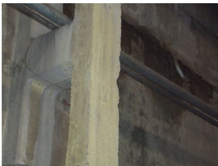
Рис. 3. Мелкие сколы и выбоины на железобетонных колоннах (Категория В)
