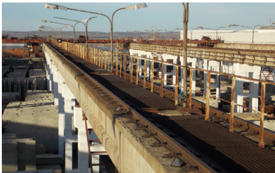
Рис. 5. Нарушение лакокрасочного покрытия конструкций металлической площадки, следы коррозии металла (Категория В)
