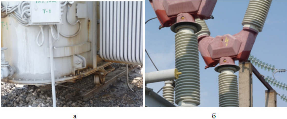
Рис. 2. Подтеки масла трансформатора Т1 (а) и секционного масляного выключателя (б) трансформаторной подстанции ПС 110/10 кВ «0...»
