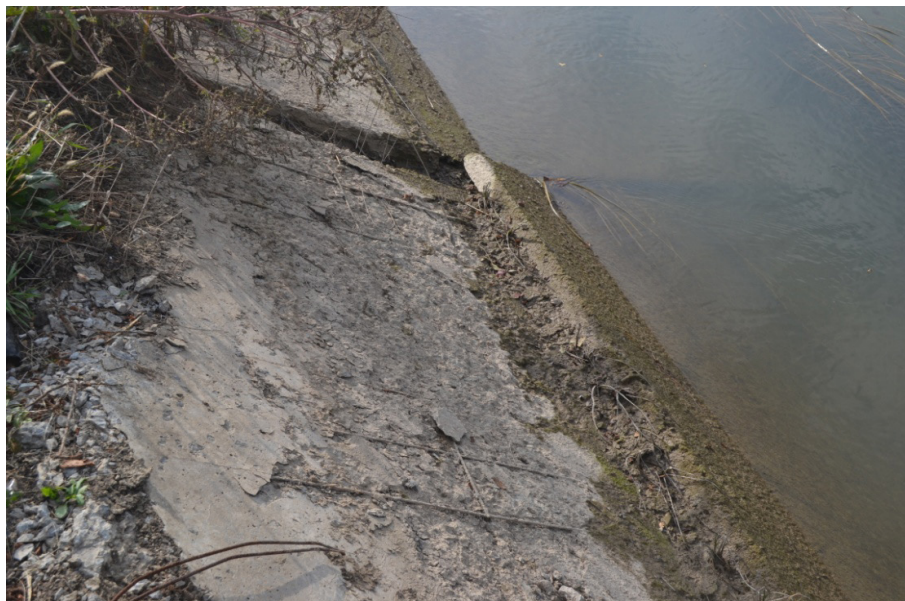
Рис. 1. Поврежденный участок бетонопленочной облицовки канала
